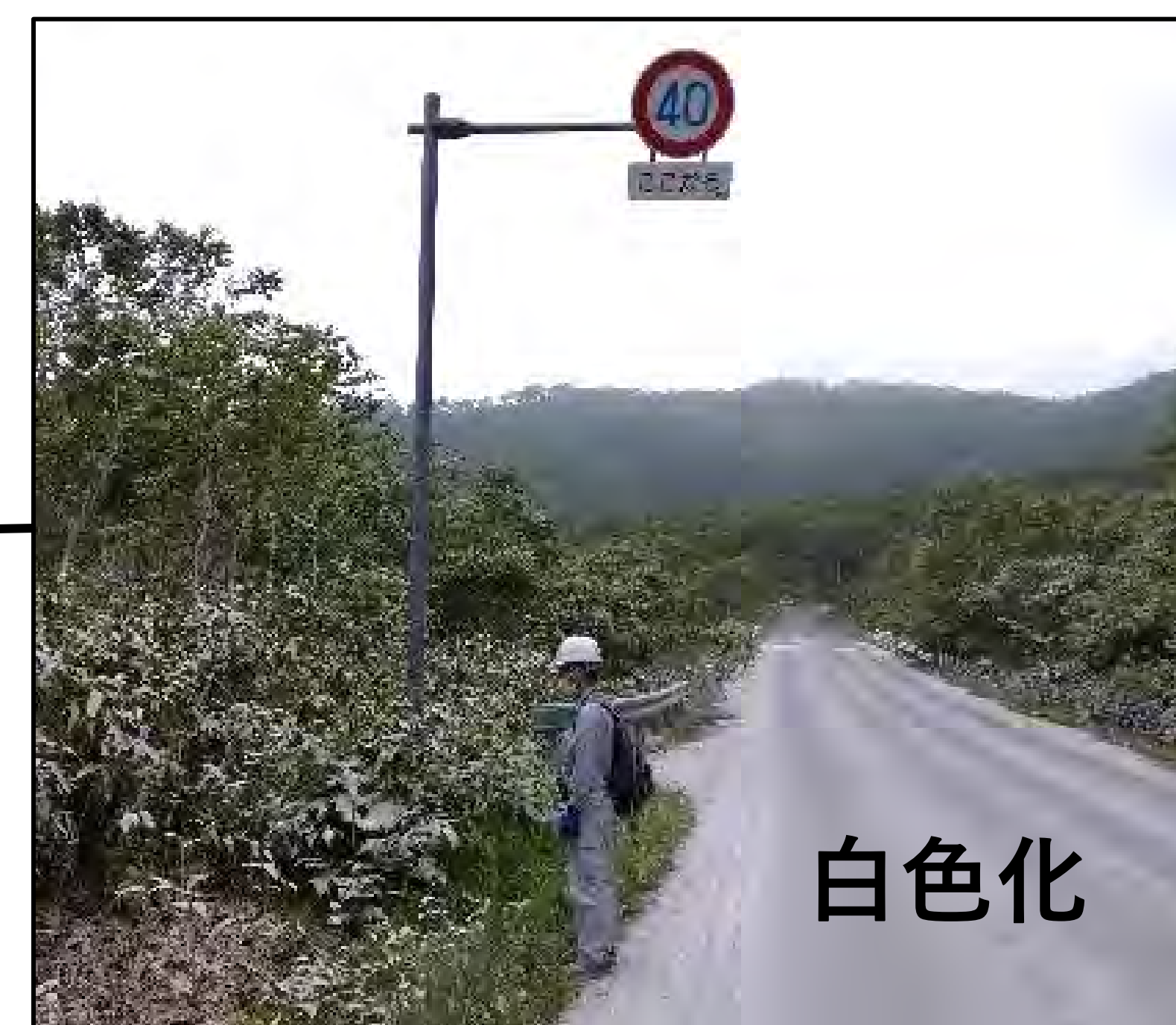
道路上に堆積した噴出物 (2023/6/30)
